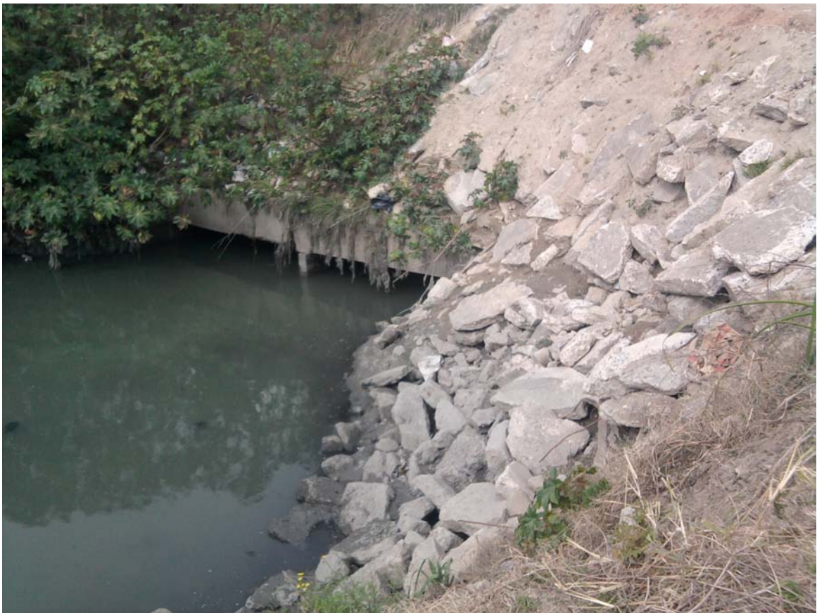
Conducto pluvial Olazabal (uno de los tres principales de Lanús Oeste), esta tapado en un 70%.
